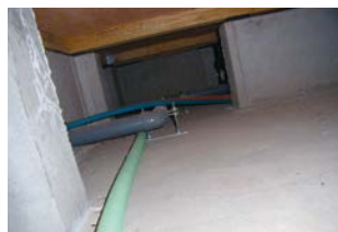
床下での基礎の欠損の確認
